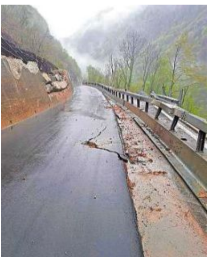
Nach Felssturz: Die Calancastrasse wurde leicht beschädigt und blieb kurzzeitig gesperrt. Bild: Tiefbauamt Graubünden
